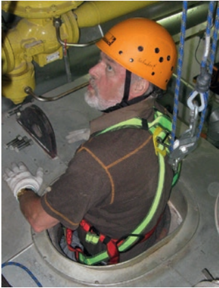
Mannloch eines Großraumdampfkessels
